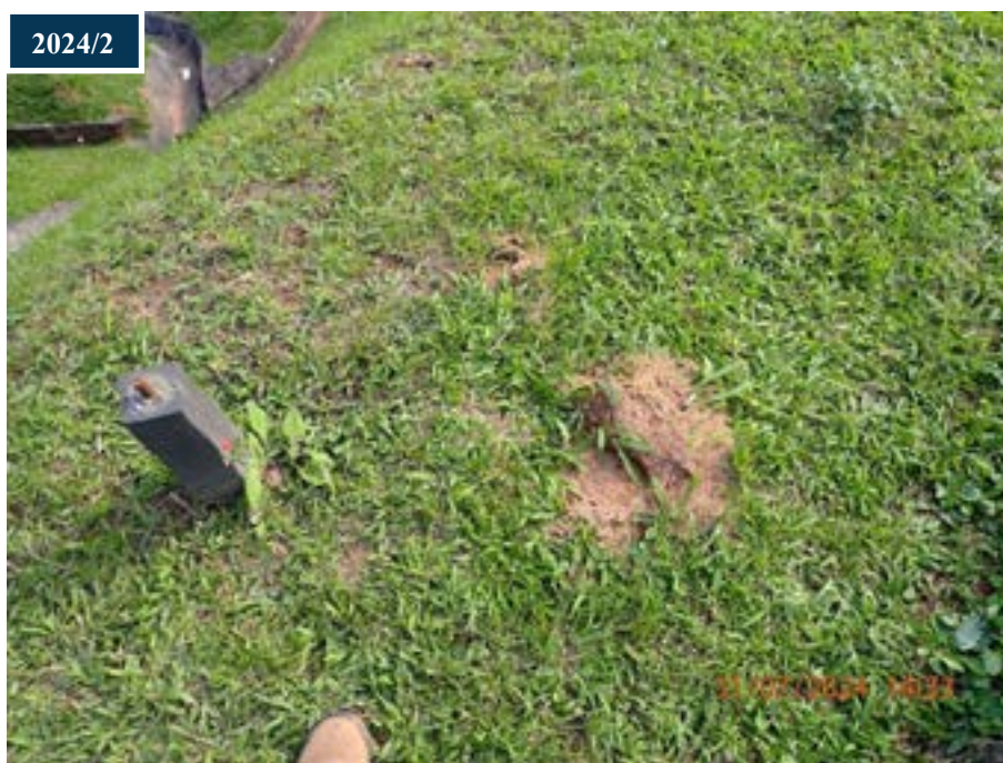
Figura 35: Continuidade da presença de formigueiros na ombreira esquerda a jusante.
