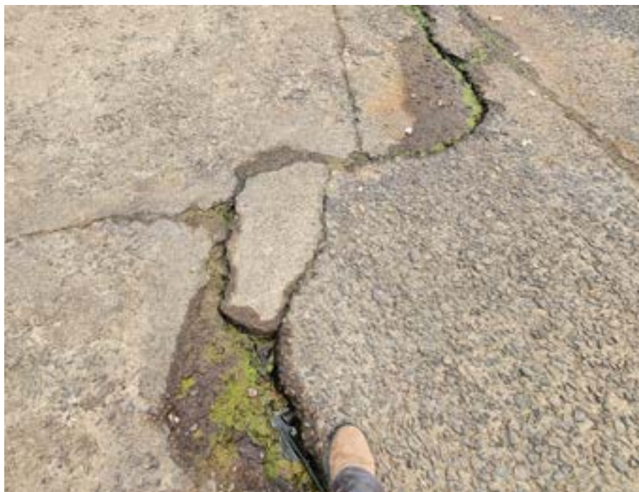
Figura 43: Indícios de surgência no interior da fissura no rápido.
