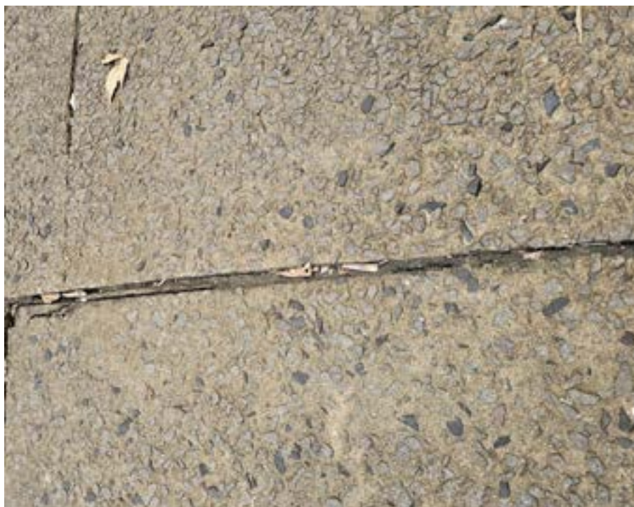
Figura 48: Deterioração nas juntas entre blocos de concreto do canal rápido.
