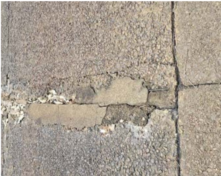
Figura 45: Camada de recobrimento das armaduras removida devido a fissuras e deterioração.
