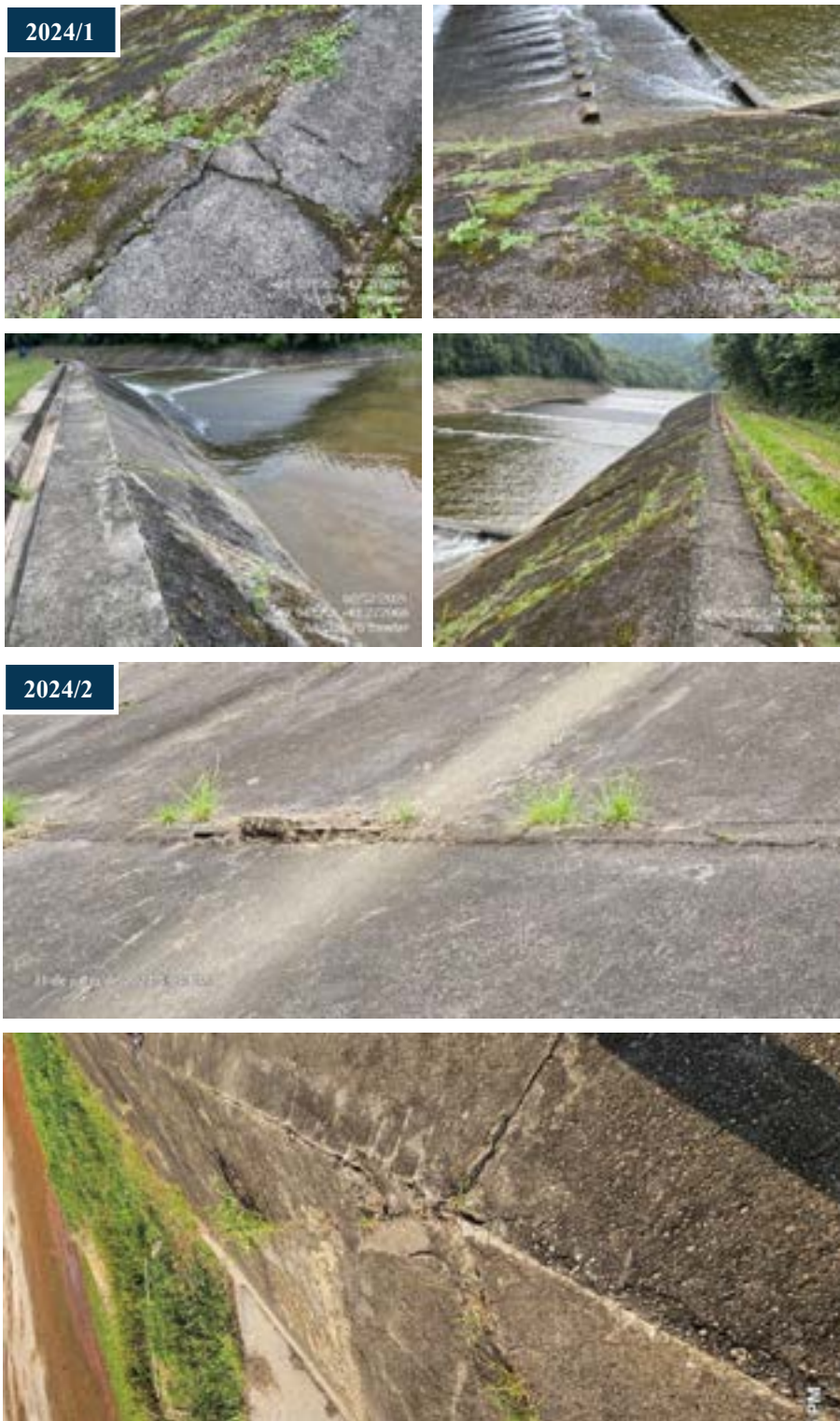
Figura 51: Continuidade da situação das fissuras e deterioração nos muros laterais.
