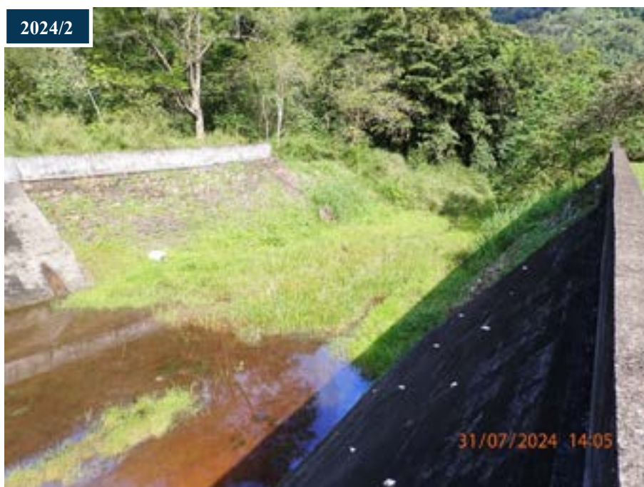
Figura 68: Comparativo entra a situação observada da vegetação aquática na bacia de dissipação.
