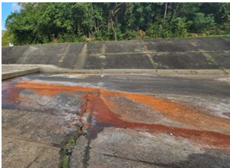
Figura 44: Evidências de carreamento através de fissuras ao longo do rápido.
