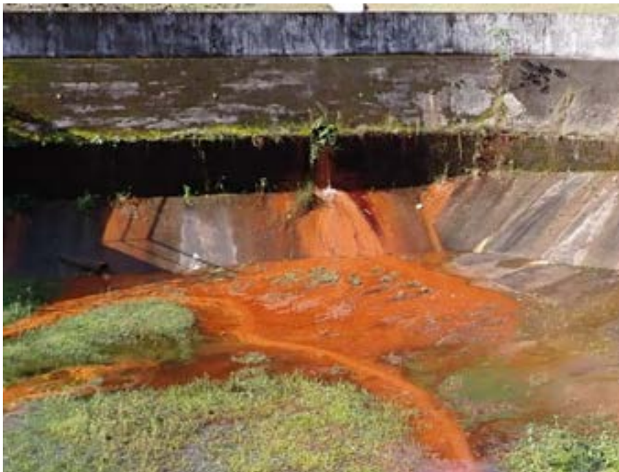
Figura 72: Drenos operando com acúmulo de vegetação e coloração alaranjada causada por sedimentos ou ferro-bactérias.
