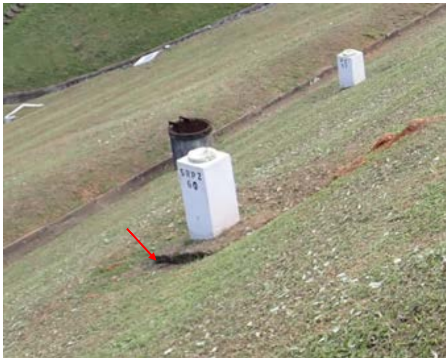
Figura 15: Descalçamento devido a erosão regressiva na interface entre o solo e a base do instrumento.
