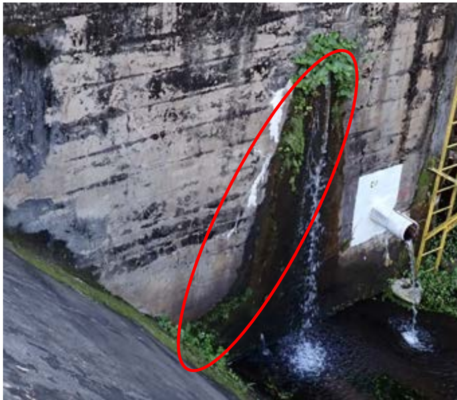
Figura 66: Fissura extensa com crescimento de vegetação no interior da bacia.
