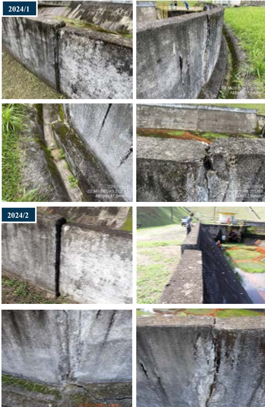
Figura 70: Comparativo entre as fissuras e desalinhamento dos muros de proteção observados nas inspeções de 2024.
