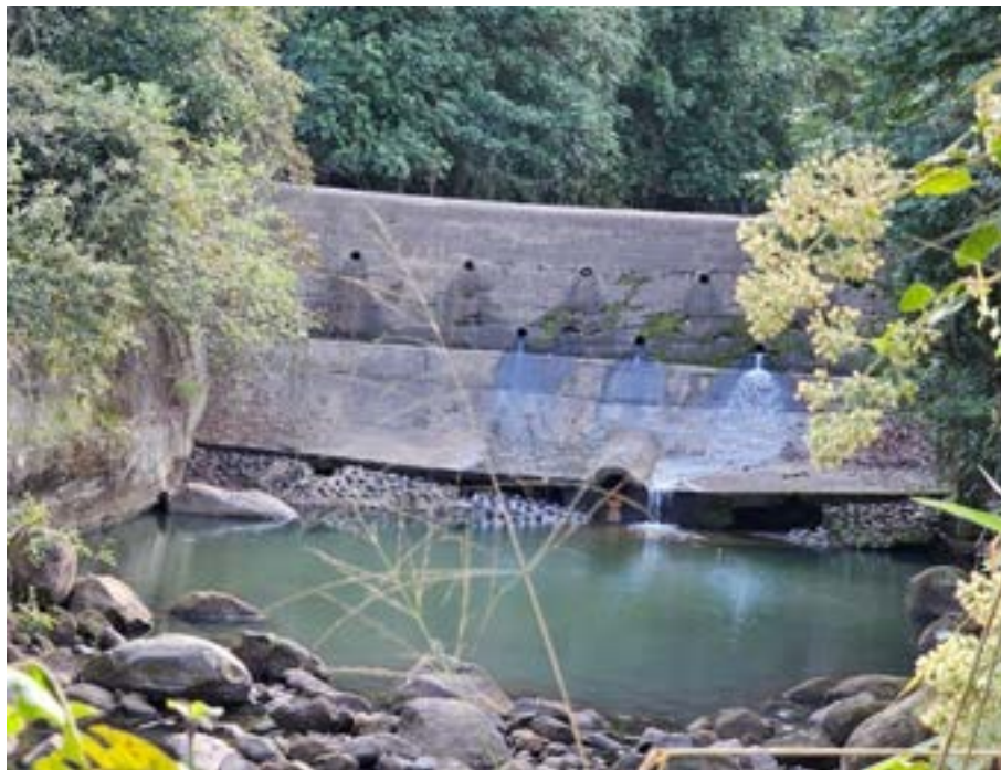
Figura 38: Dissipador de energia presente no canal de restituição.
