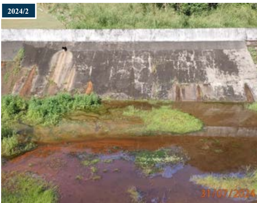
Figura 69: Comparação entre a deterioração do concreto, deslocamento, fissuras e vegetação na parede lateral.
