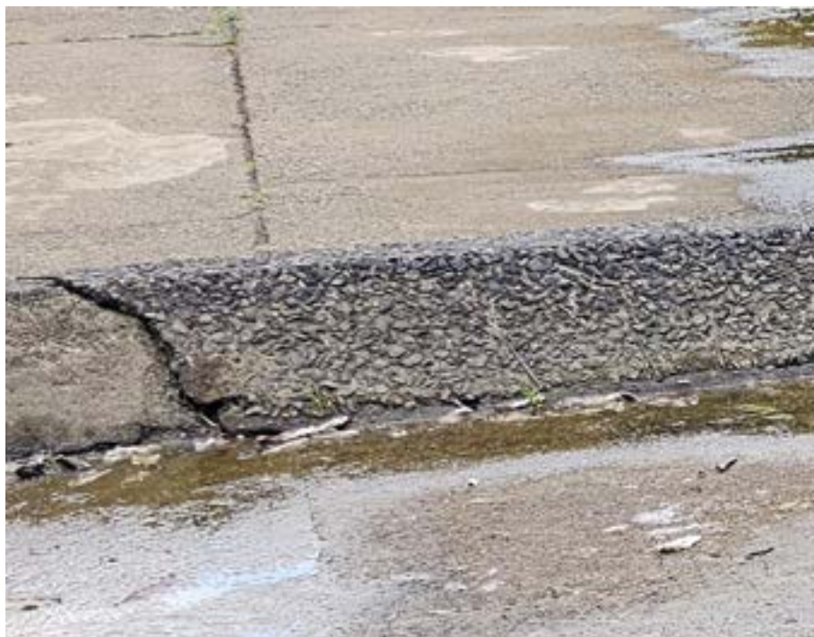
Figura 47: Fissura, deterioração e malha metálica exposta na viga defletora.
