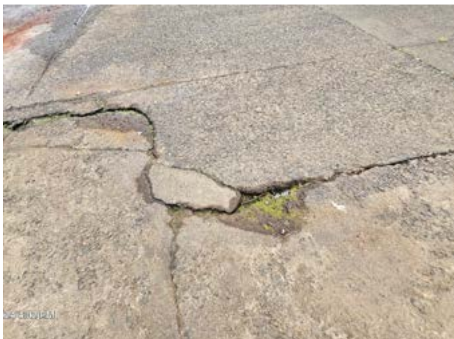
Figura 42: Fissura transversal no rápido apresentando umidade no entorno.
