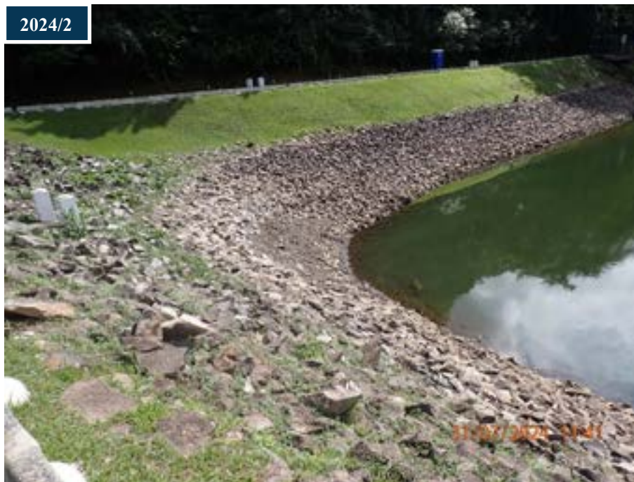
Figura 7: Diminuição da extensão do crescimento vegetal sobre o enrocamento.
