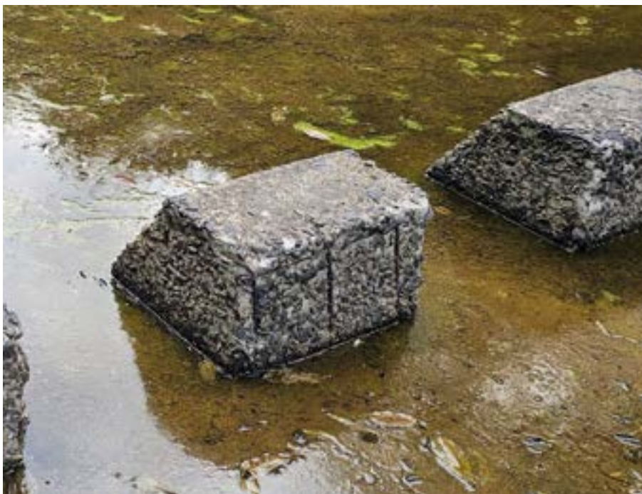
Figura 46: Deterioração dos dentes defletores com exposição de armaduras metálicas.
