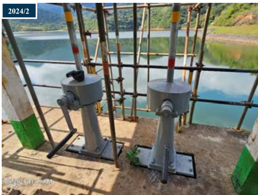
Figura 58: Hastes de operação das comportas reinstaladas após manutenção.
