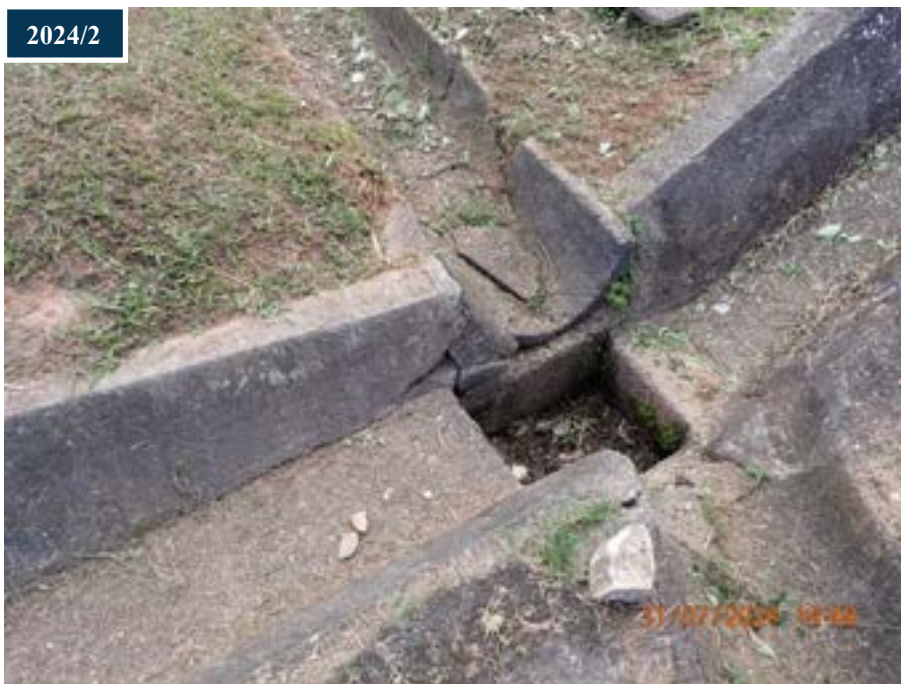
Figura 17: Permanência de canaletas danificadas e obstruídas por vegetação e sedimentos.
