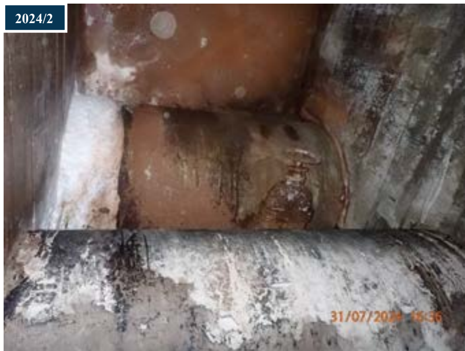
Figura 63: Poço de visita localizado dentro da edificação com escada de acesso sofrendo processo de corrosão e pequeno acúmulo de água no piso.
