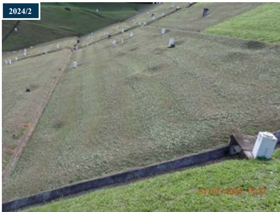
Figura 16: Continuidade da presença de afundamentos na seção intermediária do talude. Provavelmente são cicatrizes de instrumentos antigos, escavação e/ou sondagens.
