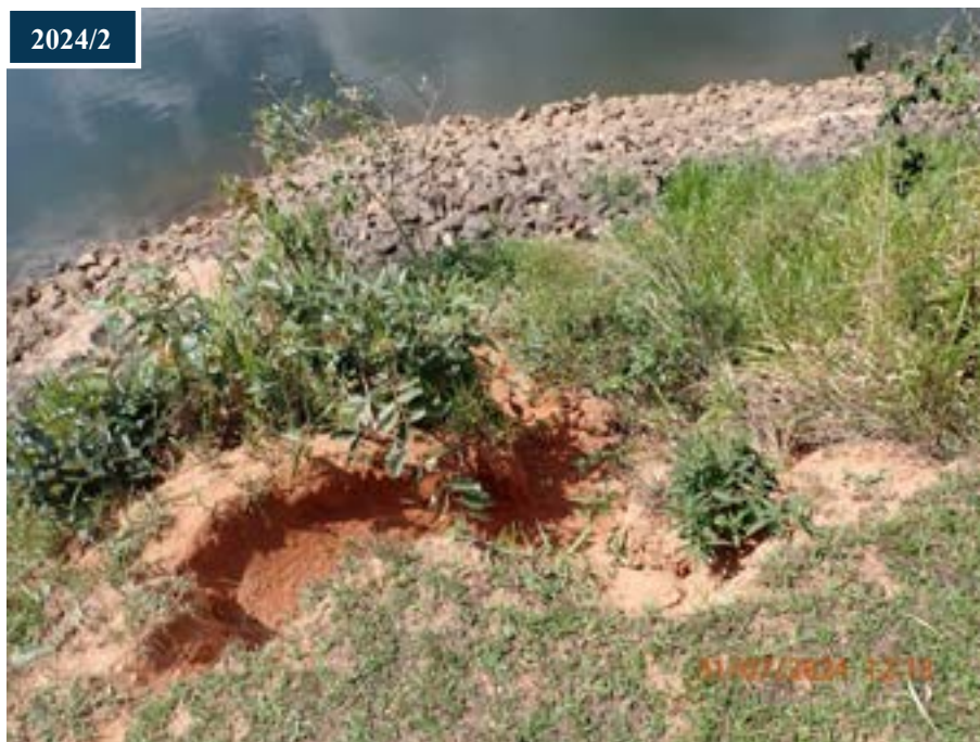
Figura 31: Erosão na ombreira esquerda a montante permanece inalterada.
