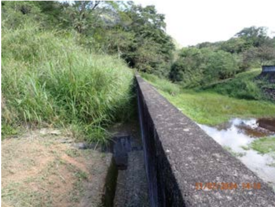
Figura 22: Vegetação arbustiva excessivo impedindo acesso total da lateral esquerda do descarregador.
