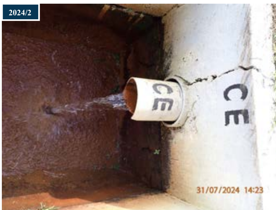
Figura 20: Continuação do aparecimento de material formado por ferrobactérias na saída dos drenos.
