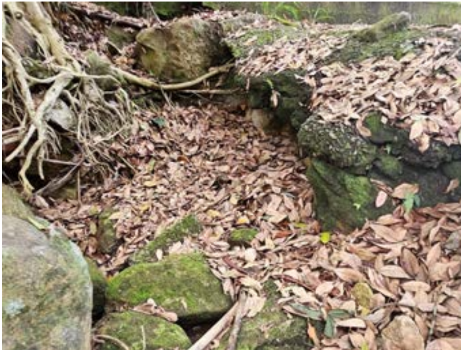
Figura 50: Erosão regressiva ao fim do rápido evidenciando descalçamento da estrutura e crescimento das fissuras.
