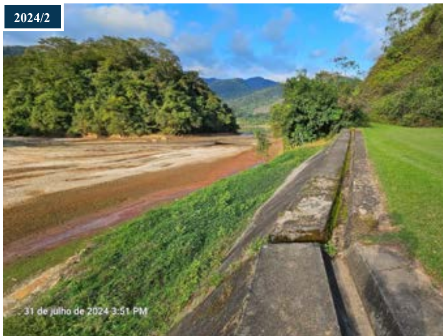
Figura 39: Situação observada nos paramentos do canal de aproximação nas inspeções de 2024.
