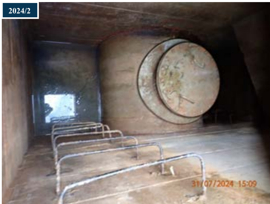
Figura 64: Continuidade do processo corrosivo da escada e acúmulo d'água no poço de visita próximo ao volante da descarga.
