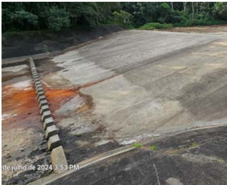
Figura 41: Soleira vertente apresenta infiltração com indícios de carreamento de finos.
