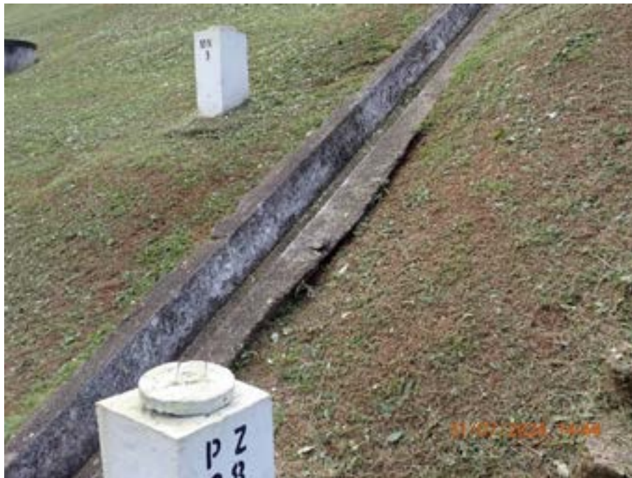
Figura 14: Descalçamento devido a erosão regressiva na interface entre o solo e a canaleta.
