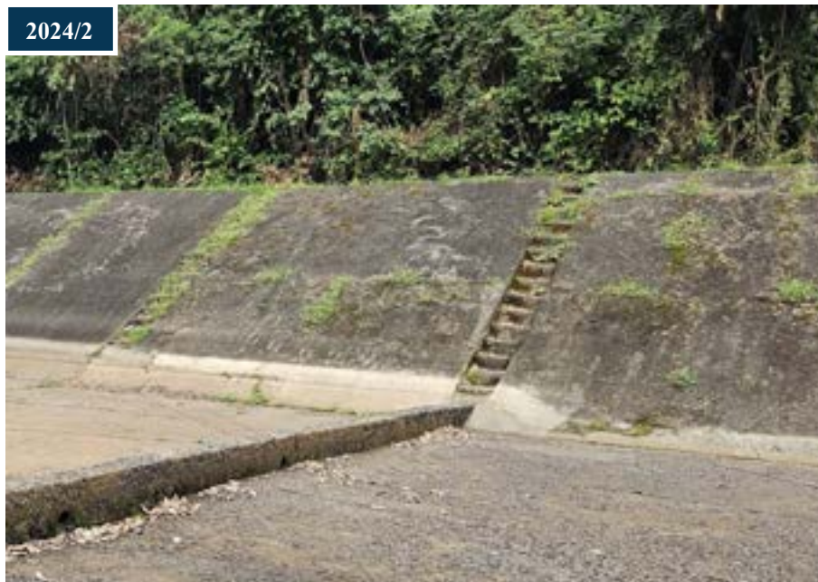
Figura 52: Deterioração das juntas do muro lateral devido ao crescimento de vegetação.
