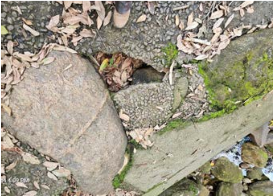
Figura 49: Porção deteriorada do canal rápido com acúmulo de matéria orgânica no interior da fissura.
