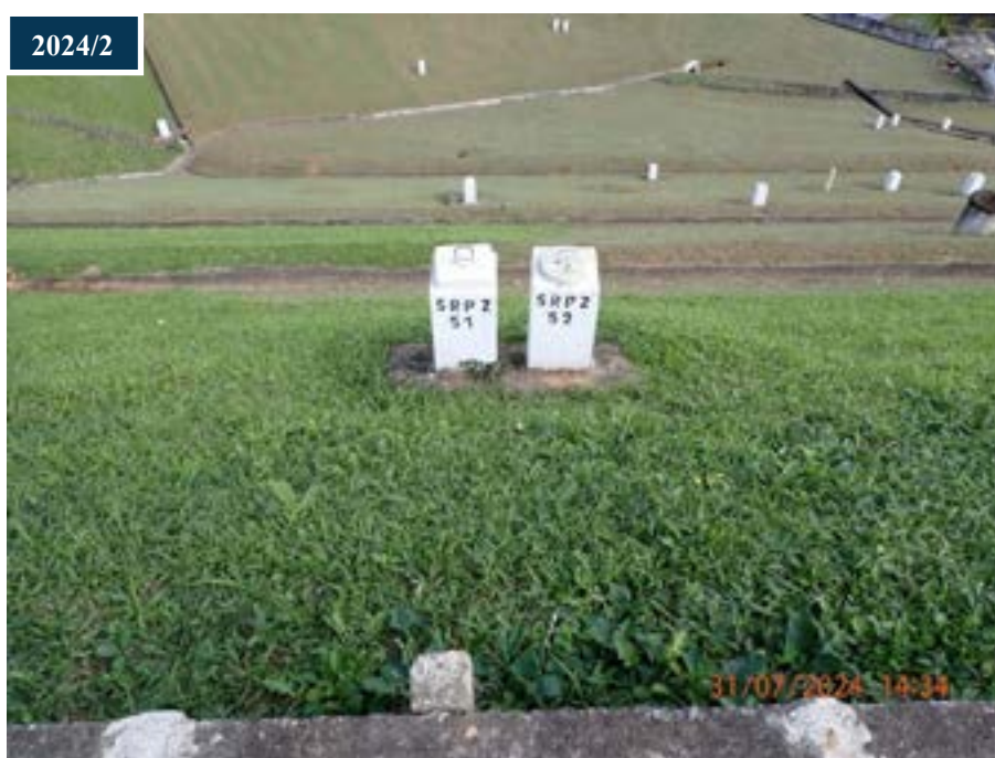
Figura 24: Ausência de tampas observada em inspeções anteriores sanada.
