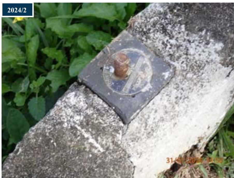
Figura 28: Comparativo entre marcos com fissura e barra enferrujada.
