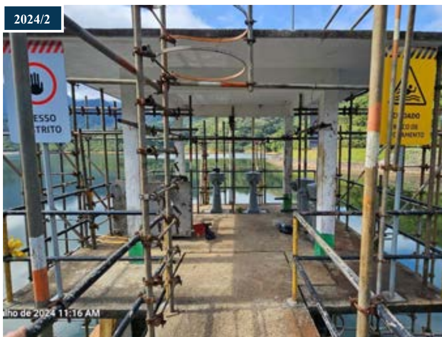
Figura 61: Guarda corpo da passarela de acesso se encontra com a pintura danificada.
