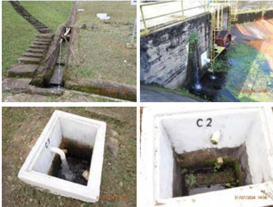
Figura 30: Dreno coletores para medição da vazão. Atualmente o Dreno C2 apresenta-se gotejando.
