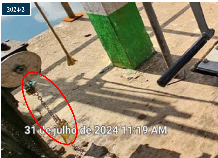
Figura 60: Equipamento permanece cadeado para prevenção de abertura da comporta de forma acidental.
