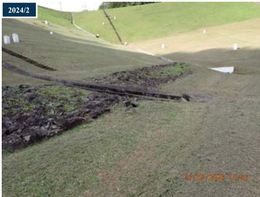
Figura 19: Continuidade da presença generalizada de vegetação no enrocamento do dreno de pé.
