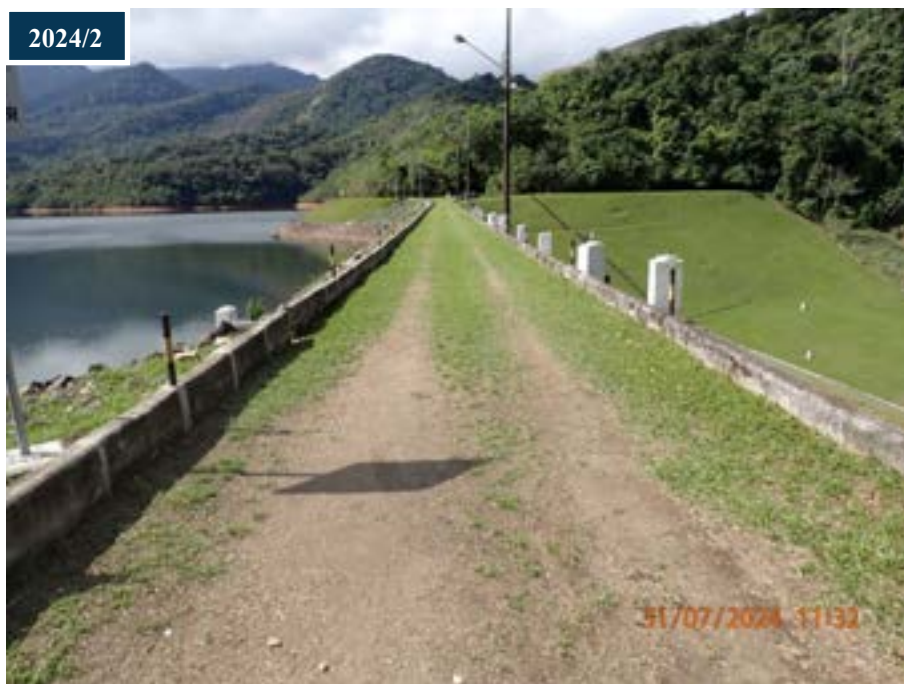
Figura 10: Trechos com falha no revestimento vegetal junto a ombreira direita.
