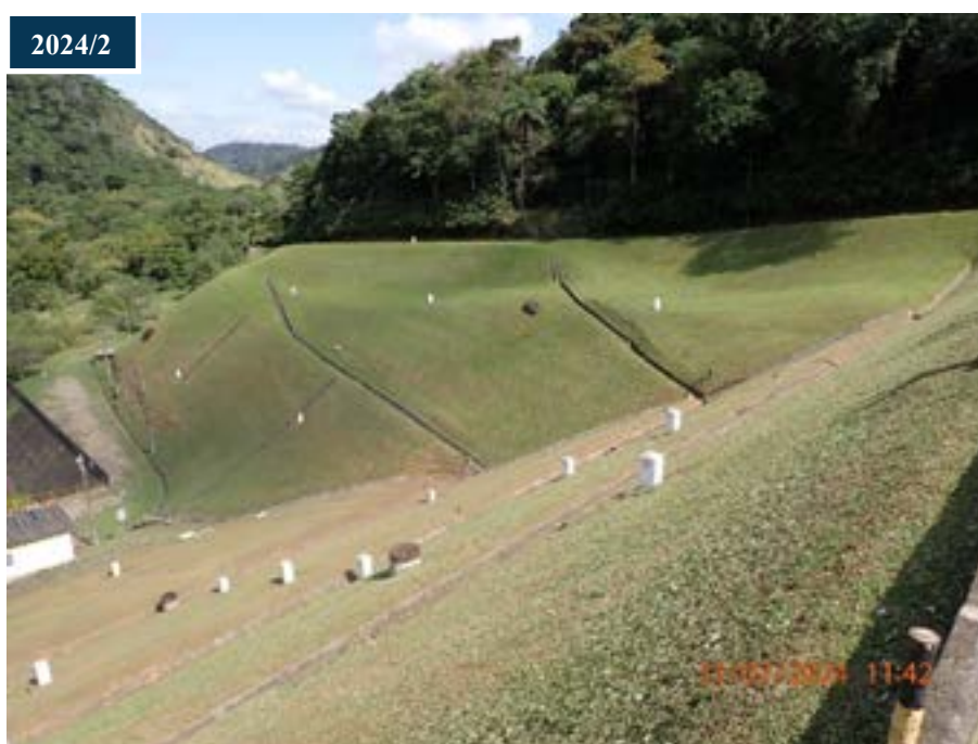
Figura 34: Permanência da presença de matacão na ombreira direita a jusante.
