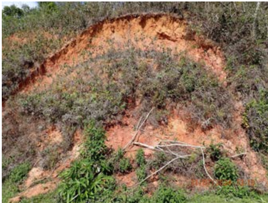
Figura 32: Escorregamento de talude sobre a ombreira esquerda a montante.
