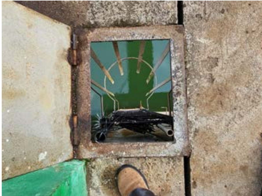
Figura 55: Instrumentos de aferição do nível d'água no reservatório.
