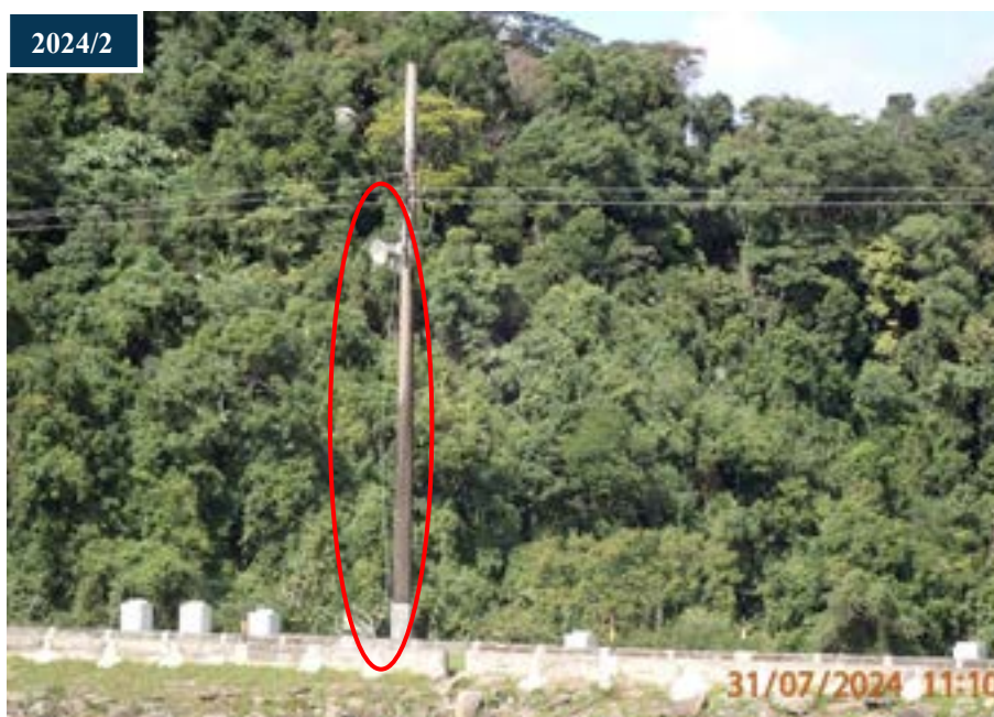
Figura 3: Continuidade do problema de energia na barragem evidenciado pelo cabeamento interrompido.
