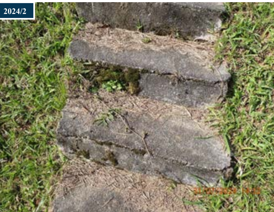
Figura 29: Escada de acesso íngreme se encontra deteriorada.
