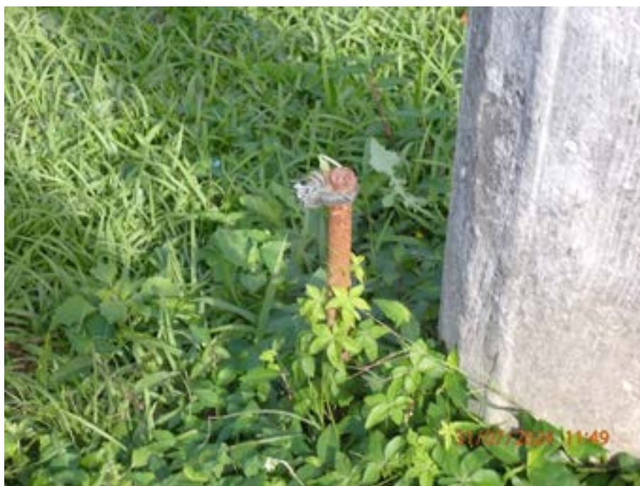
Figura 5: Deficiência no mecanismo de aterramento.
