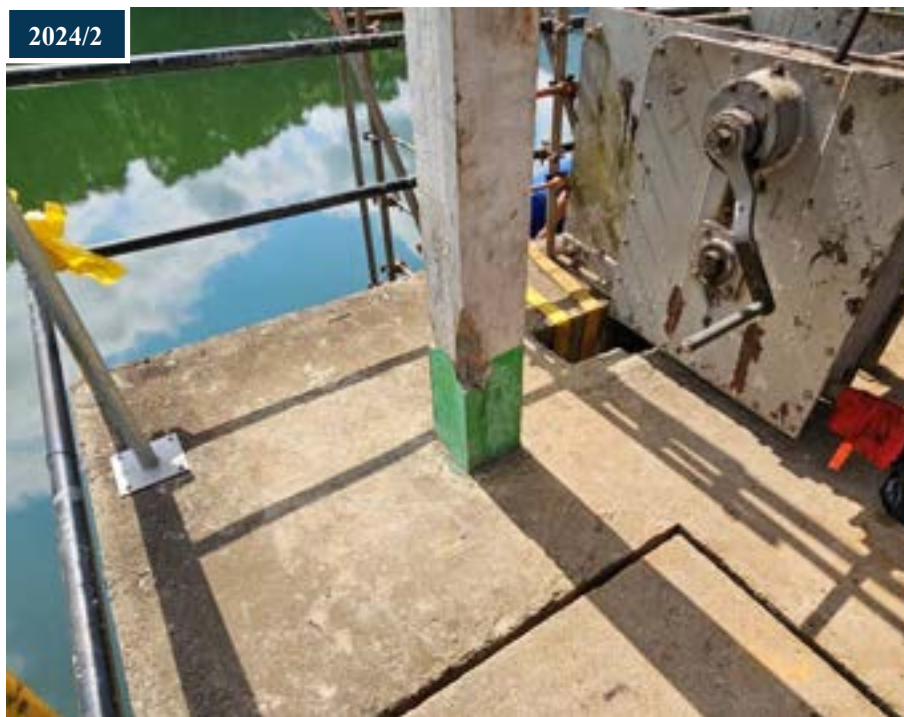
Figura 59: Comparativo entre a fissura no pilar da torre durante as inspeções de 2023 e 2024.
