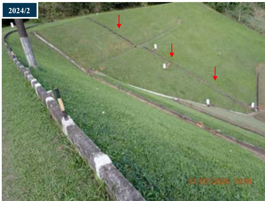
Figura 26: Ausência de corrimão, linha de vida ou demais equipamentos de segurança, expondo os operadores ao risco durante a leitura dos instrumentos e roçagem dos taludes.
